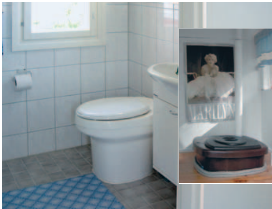
Сухой туалет для установки внутри дома: контейнеры для отходов жизнедеятельности расположены в подвальном этаже
