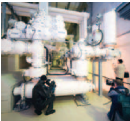
Комплексное распределительное устройство на 220 кВ (РТЭС «Строгино»)
