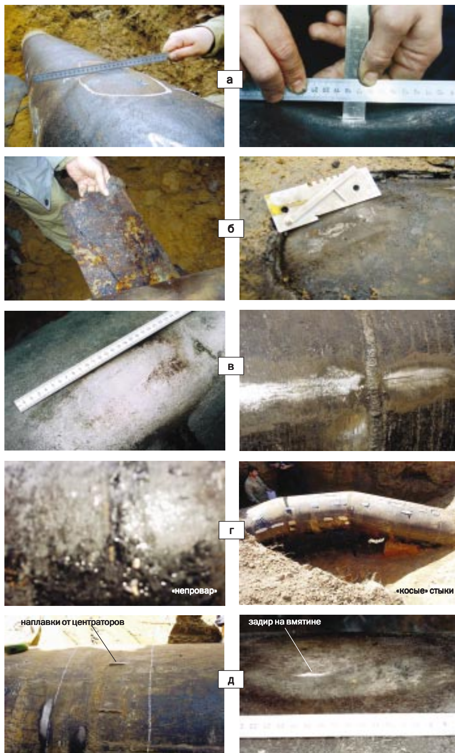
Рис. 1. Дефекты металла газораспределительных и тепловых сетей России: а) вмятины, б) локальная коррозия под отслоившимся покрытием; в) трещины в области вмятин и в околосварной зоне; г) недопустимые дефекты сварных соединений; д) брак строительного-монтажных работ.
