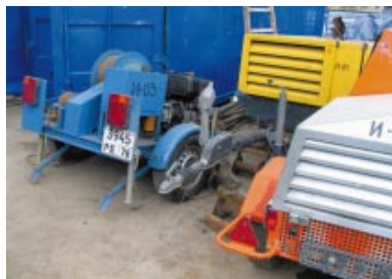
Фото 2-5. Оборудование, производство работ и общий вид строитель- ной площадки при восстановлении водопровода Ду 200 мм от ул. Маршала Захарова до ул. Кузнецова по методу "Сепрпайп"
